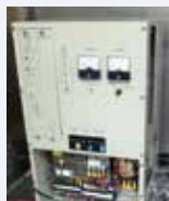
灯火制御装置
